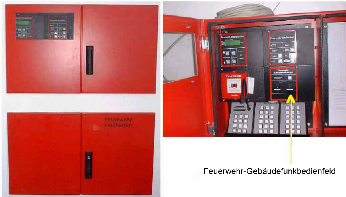
Bild 3: Beispiel zur Integration eines Feuerwehr-Gebädefunkbedienfeldes in ein Feuerweh-Informationszentrum (FIZ)
